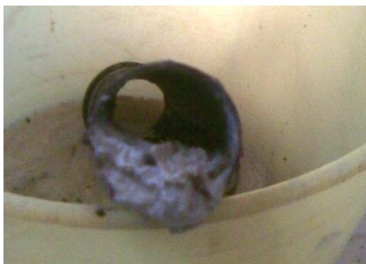
Figura 8. Incrustación en una tubería.
