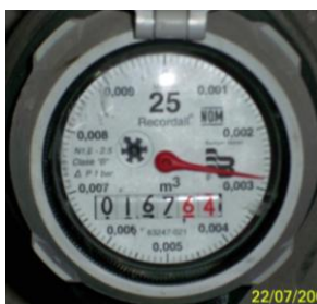
Figura 3. Medidor en funcionamiento
