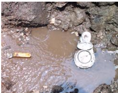
Figura 9. Medidor expuesto a sumersión y humedad.
