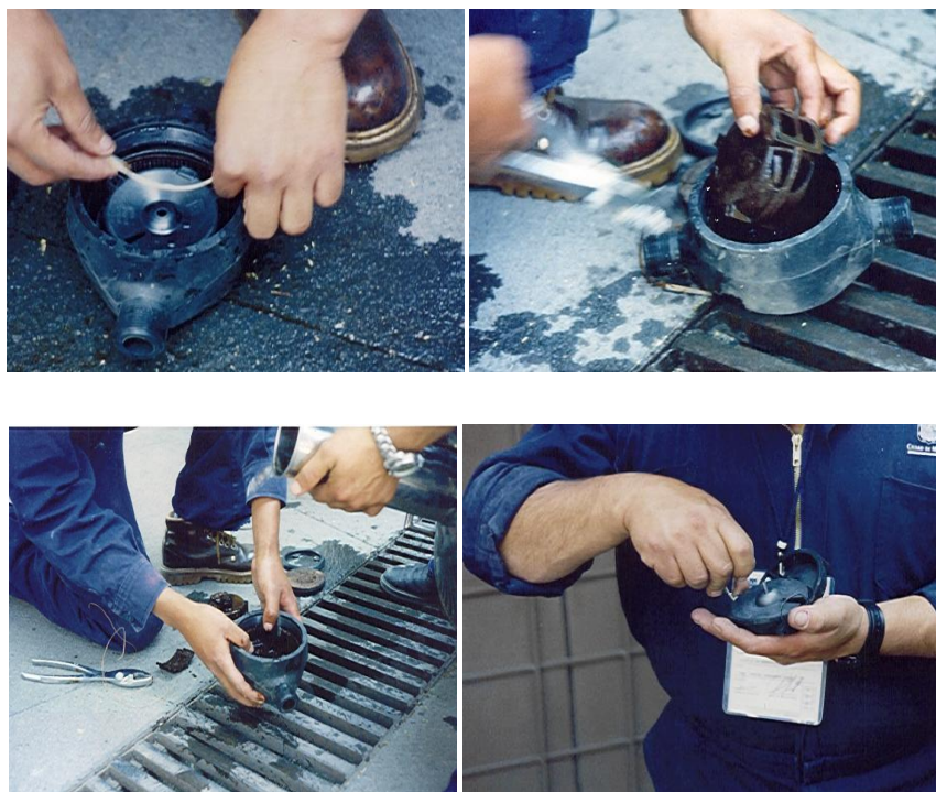
Figura 30. Desarmado de la cámara de un medidor.
