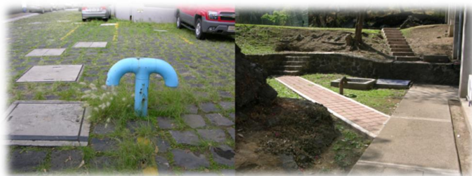
Figura 10. Cisternas de almacenamiento de agua pluvial
