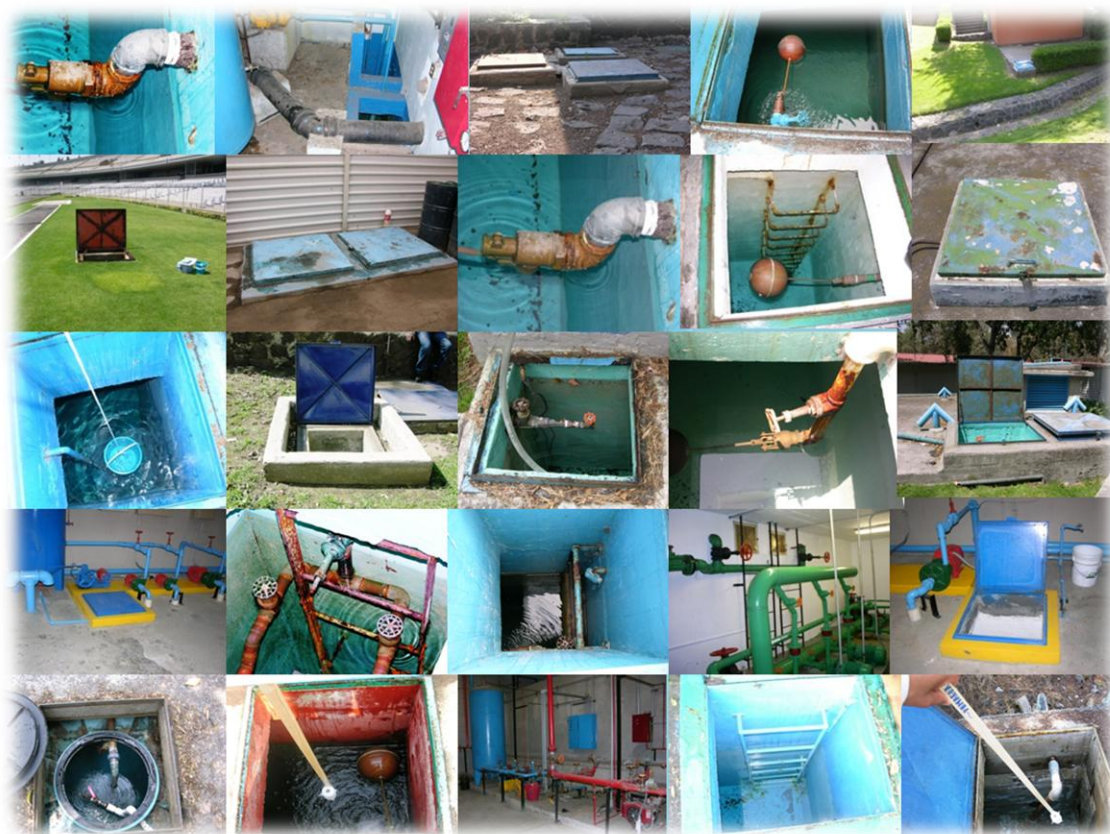
Figura 5. Cisternas de almacenamiento de agua existentes en el campi CU.
