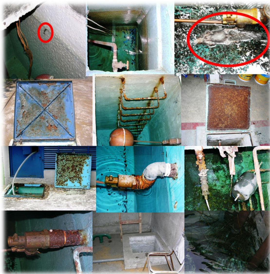
Figura 8. Estado físico de deterioro en que se encuentran algunas cisternas de almacenamiento de agua potable.
