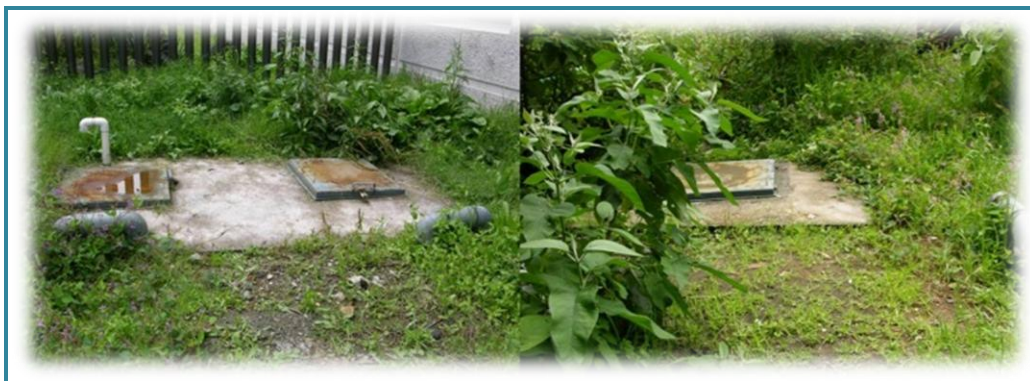
Figura 11. Cajas enterradas donde se encuentra la planta de tratamiento del IISUE.
