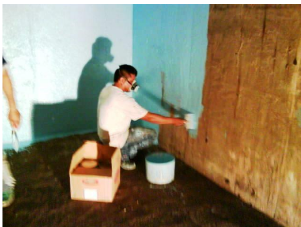
Cisterna del Centro Tecnológico Aragón
