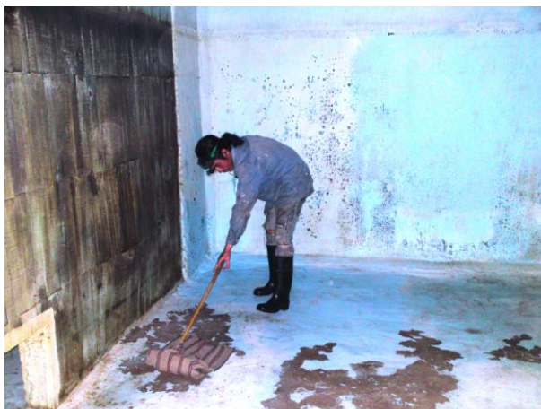
Cisterna de Mantenimiento
